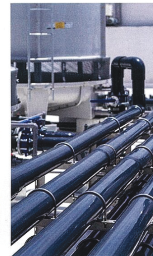
冷凍空調工程 Air Conditioning project
