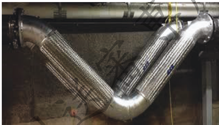
Fig. 4: V型配管實例。
