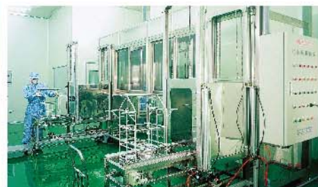
Class 10,000 無塵室 禁油洗淨設備
